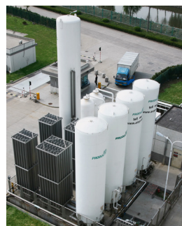
Génération de gaz sur place
