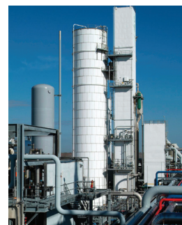
Grande unité de séparation d'air et réseau de canalisation
